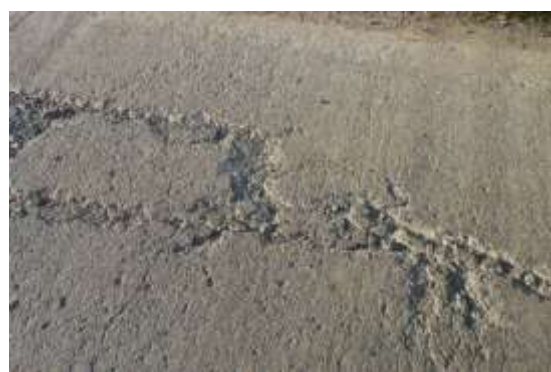
老路面板破裂
